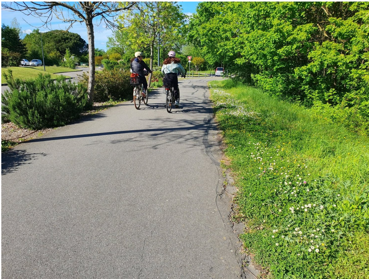
Les aménagements doivent être entretenus pour éviter leur dégradation.
